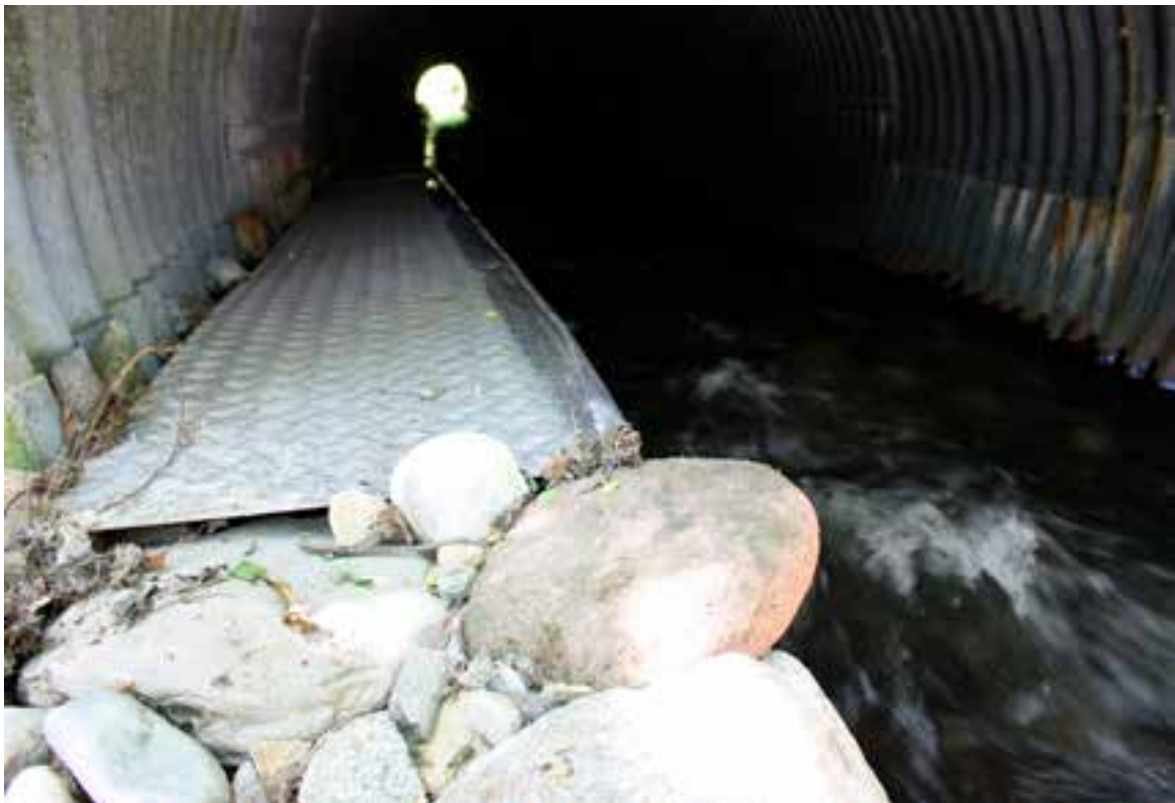
La passerella/mensola realizzata lungo la sponda sinistra del corso d'acqua e raccordata agli imbocchi tramite posa di pietrame (foto Fabio Casale).
