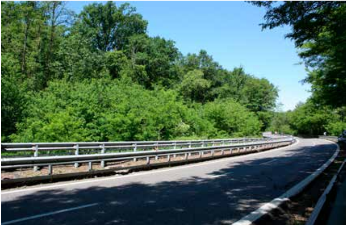
La SS 629 nel punto in cui transita sopra il torrente Acquanegra (foto Fabio Casale).
