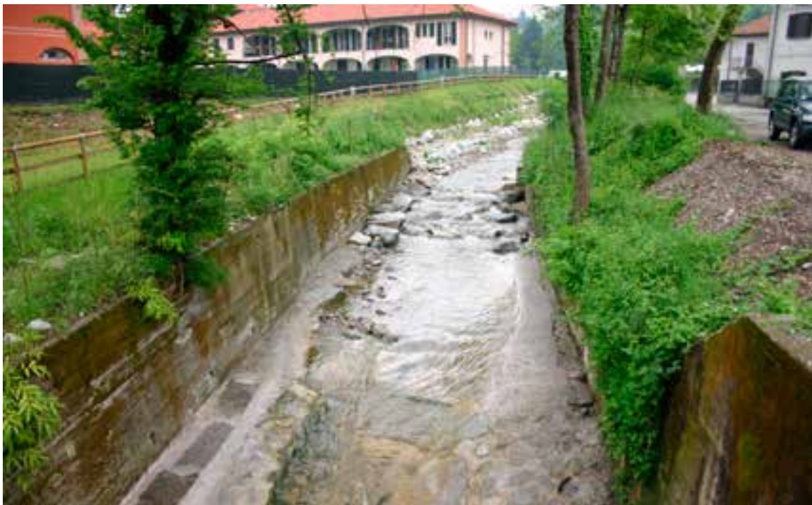
Il sito dopo gli interventi; sulla sinistra si notano, in sequenza: passaggio in cemento, passaggio con massi ammorsati fino al raccordo con la sponda percorribile (foto Provincia di Varese).
