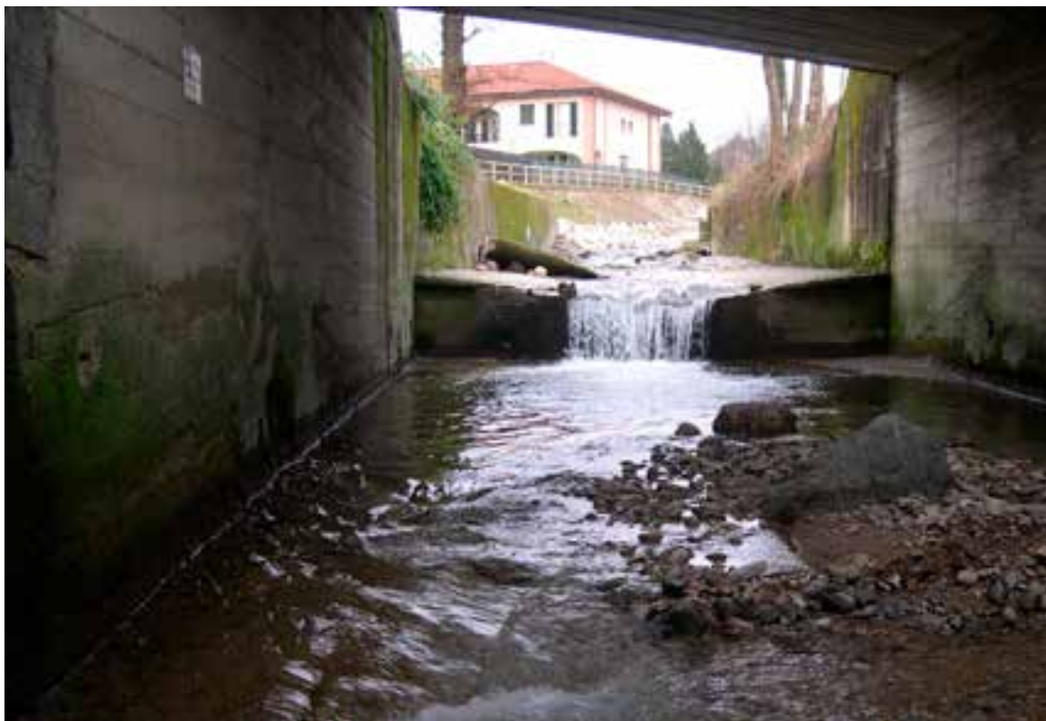
Situazione prima degli interventi, con briglia in cemento che interrompe la continuità ecologica (foto Provincia di Varese).
