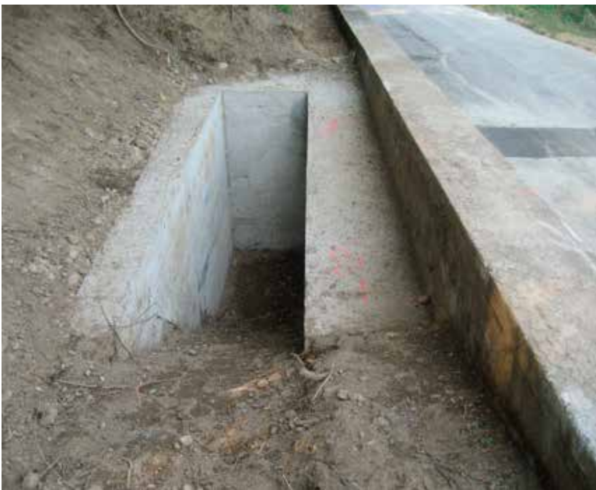
Particolare del punto di accesso (“pozzetto”) a monte del sottopasso (foto Provincia di Varese).
