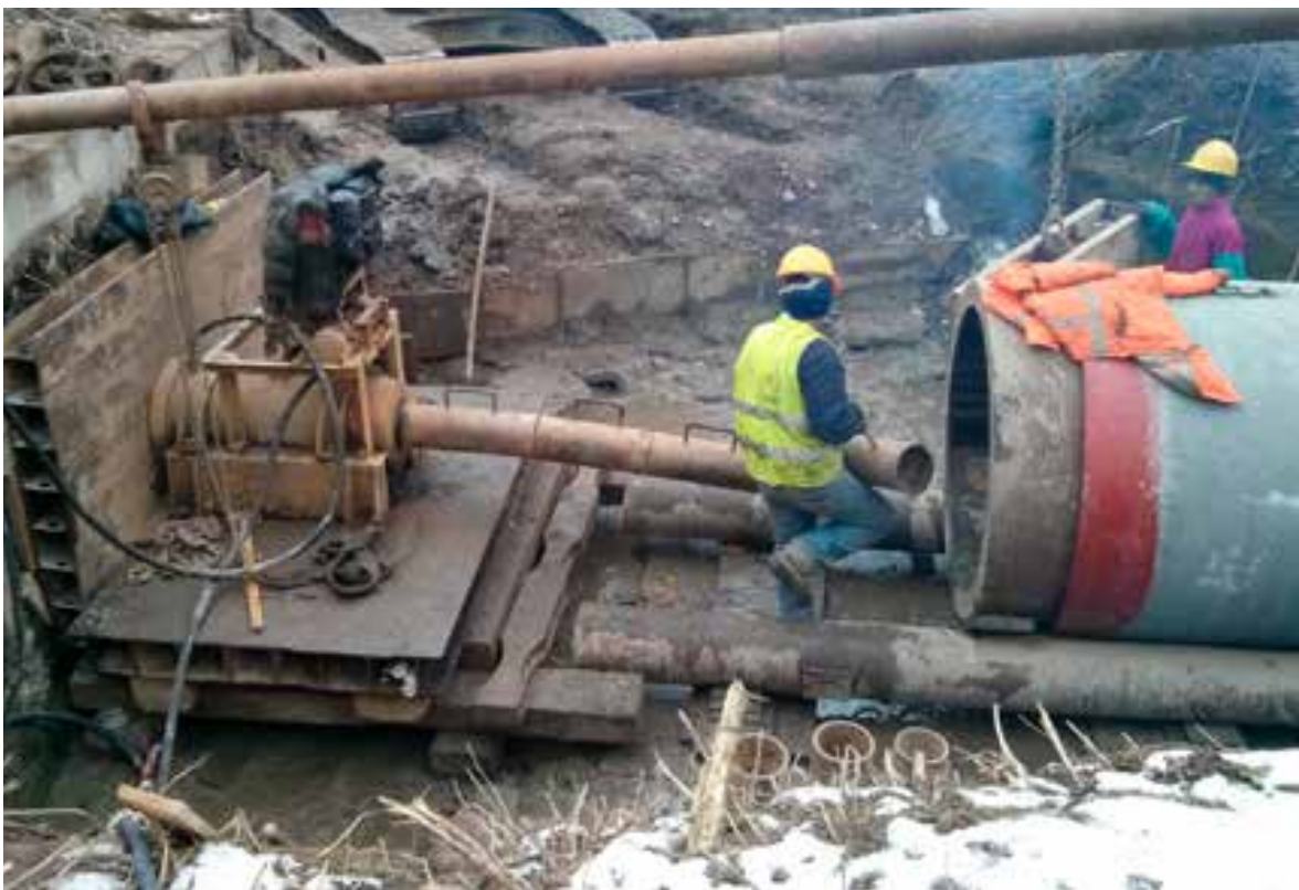
Cantiere in fase esecutiva, con la predisposizione dello spingitubo (foto Provincia di Varese).
