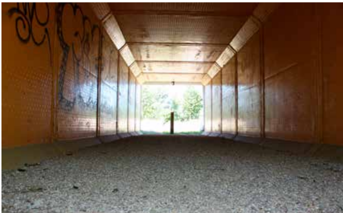
Intervento in comune di Bardello (V05), di miglioramento della superficie di calpestio di un sottopasso già esistente (pista ciclabile) tramite posa di emulsione saturata con graniglia (foto Fabio Casale).
